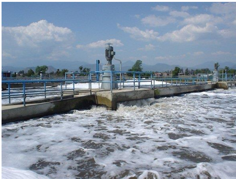
Figura 29. Foto de Planta de Tratamiento de Aguas Residuales Foto cortesía de Sedapal
